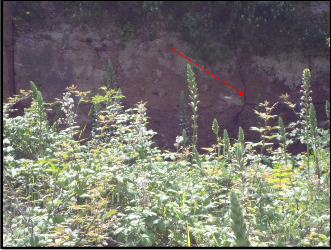
الصورة رقم (25): تصدع الجدران
