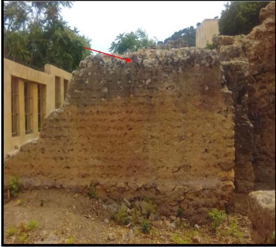
الصورة رقم (23): تأثير الرطوبة على الجدران
