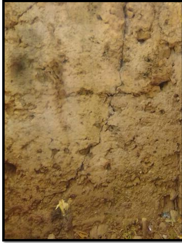
الصورة رقم (38) : تشققات بحاجة للترميم
