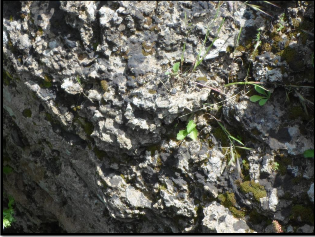
الصورة رقم (32): إ انتشار الطحالب
