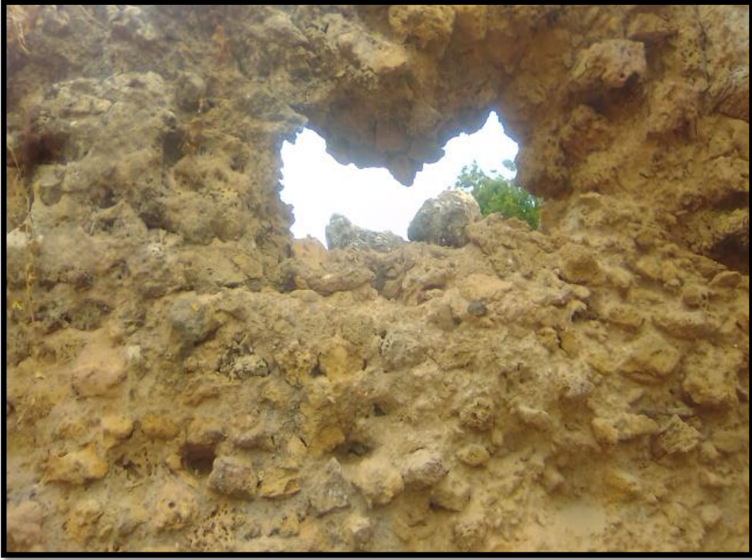
الصورة رقم (22) : إنفصال أجزاء من الجدران
