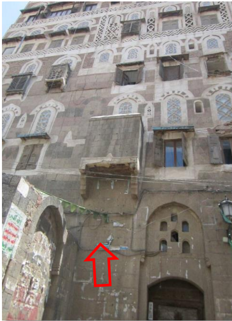
الصورة رقم (109) تشويهاات خارجية في المباني
