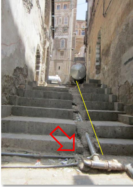
الصورة رقم (117) تشويه الشوارع الرئيسية
