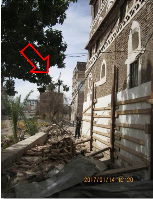
الصورة رقم (122) مباني مدمرة وأيله للسقوط ( حارة القاسمي)
