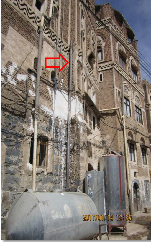
الصورة رقم (105) كوابل الطاقة الشمسية تطمس واجهات المباني
