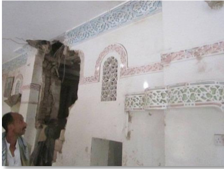
الصورة رقم (129) إحدى الغرف المدمرة في المبنى
