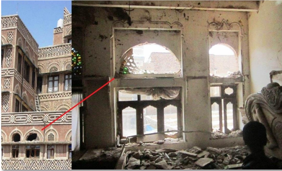
الصورة رقم (101) تدمير المباني بمدينة صنعاء
