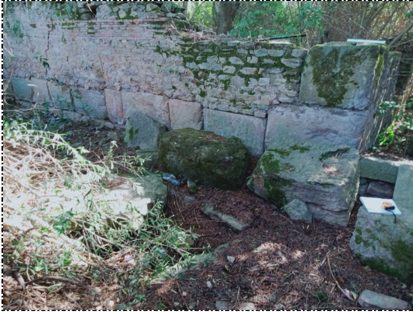
صورة رقم 174: قناة تصريف مياه الحمّامات (تصوير الطّالب)
