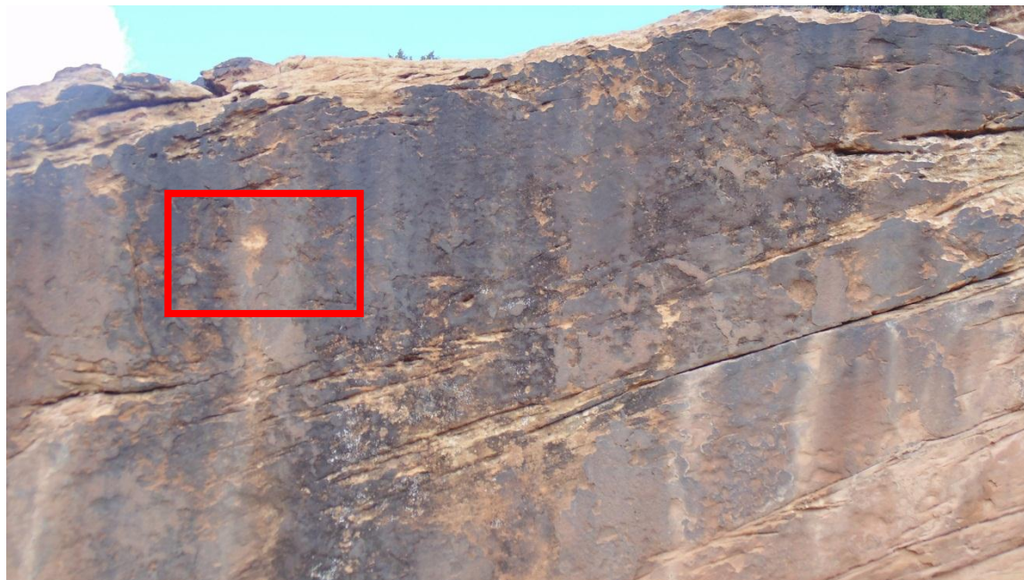
(الصورة رقم:1 تمثل تغير لون الواجهات )
