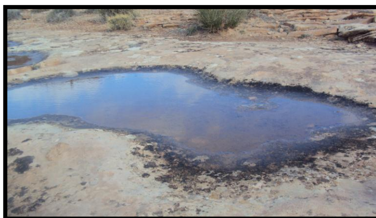
(الصورة رقم : 2 تمثل ركود مياه الأمطار فوق الجدارية )
