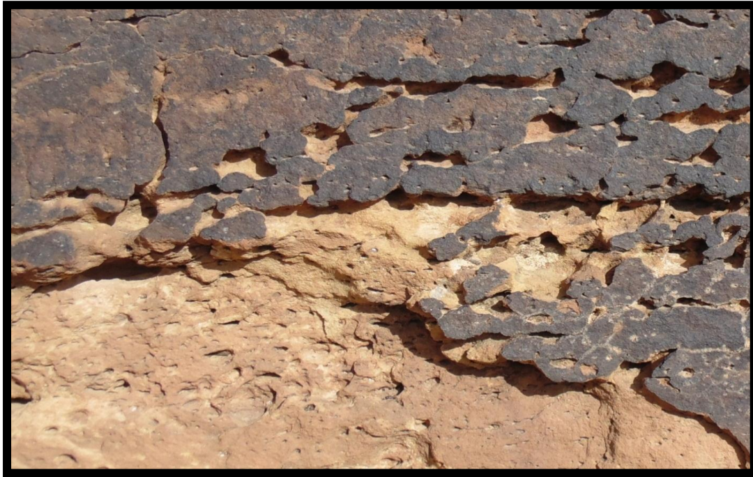
(الصورة رقم 2: تمثل تآكل اسطح الواجهات )
