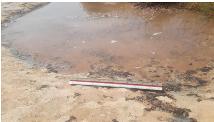
(الصورة رقم : 1 تمثل ركود مياه الأمطار فوق الجدارية )
