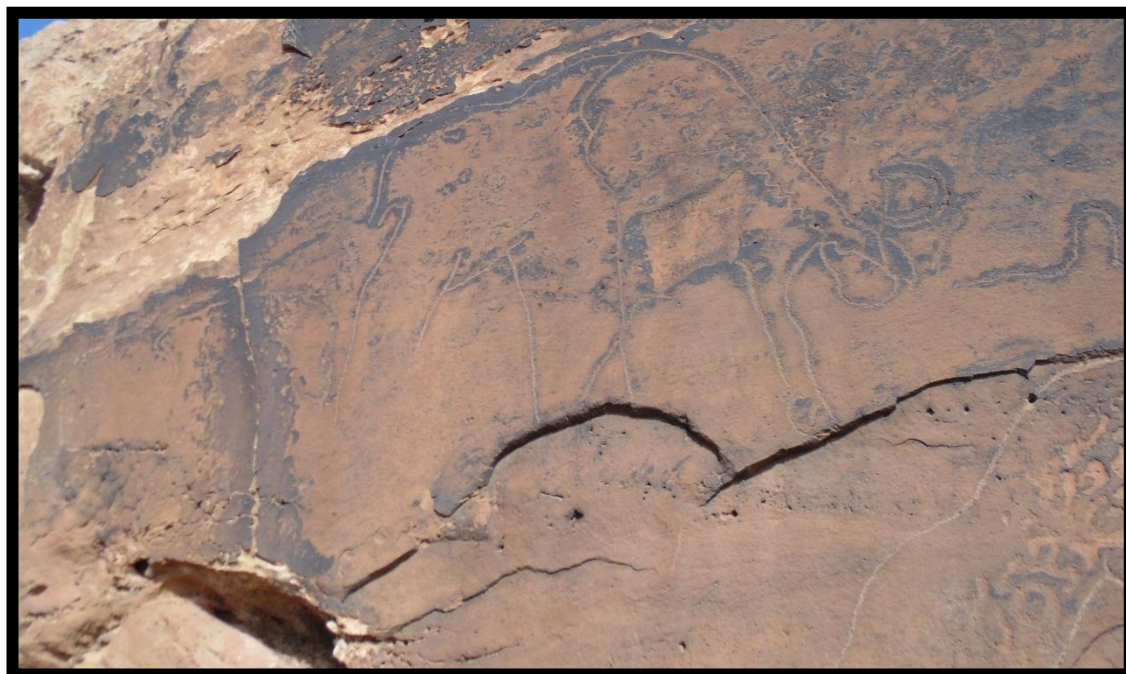
(الصورة رقم 1: تبين تقشر أسطح الواجهات )
