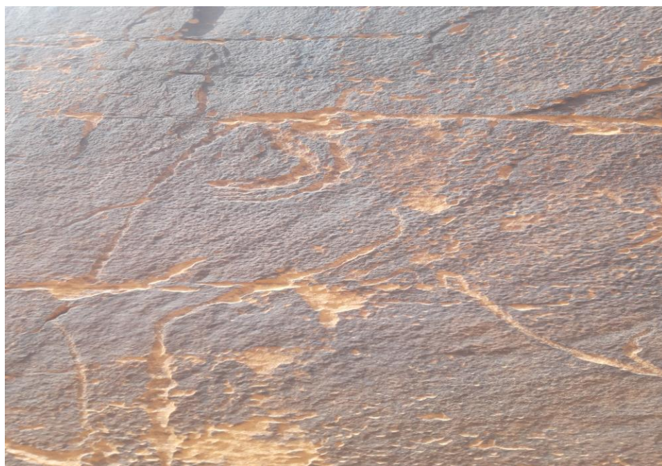
(الصورة رقم:2 توضح عملية تقشر الواجهات )
