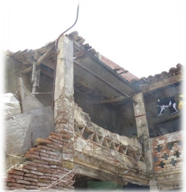
صورة (157): صورة تبين انهيار جزء كبير من المبنى
