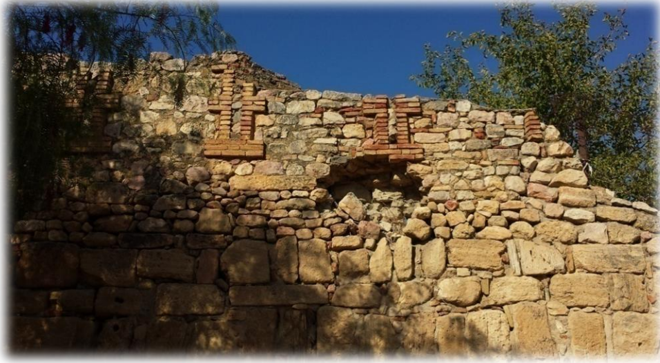
صورة (156): انهيار برج مراقبة
