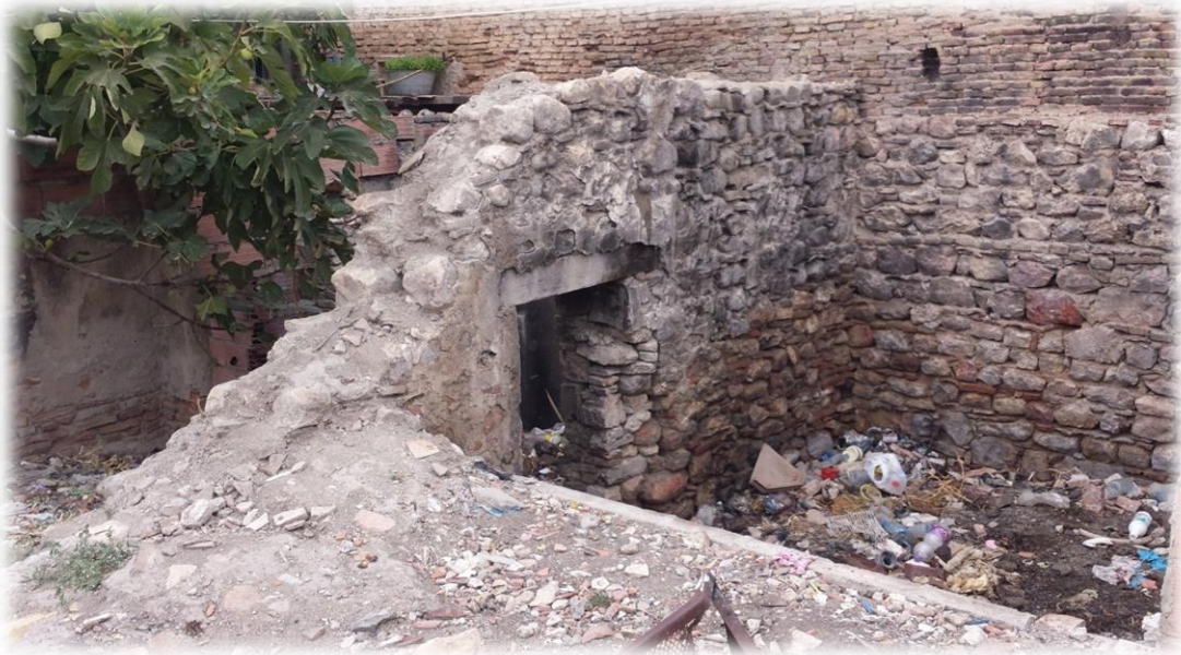
صورة (155):بقايا انهيار المباني
