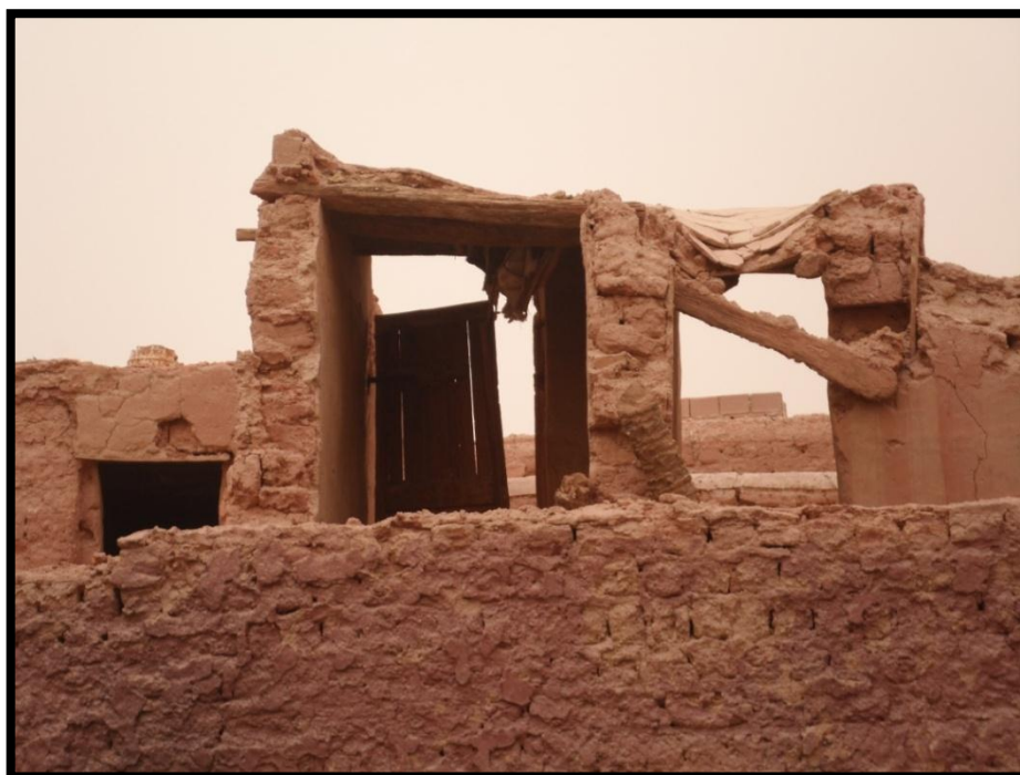
13/ب- خرائب من العمران تبين تشكيل المباني من طابقين في المساكن التقليدية خرائب من عمران المسكن التقليدي
