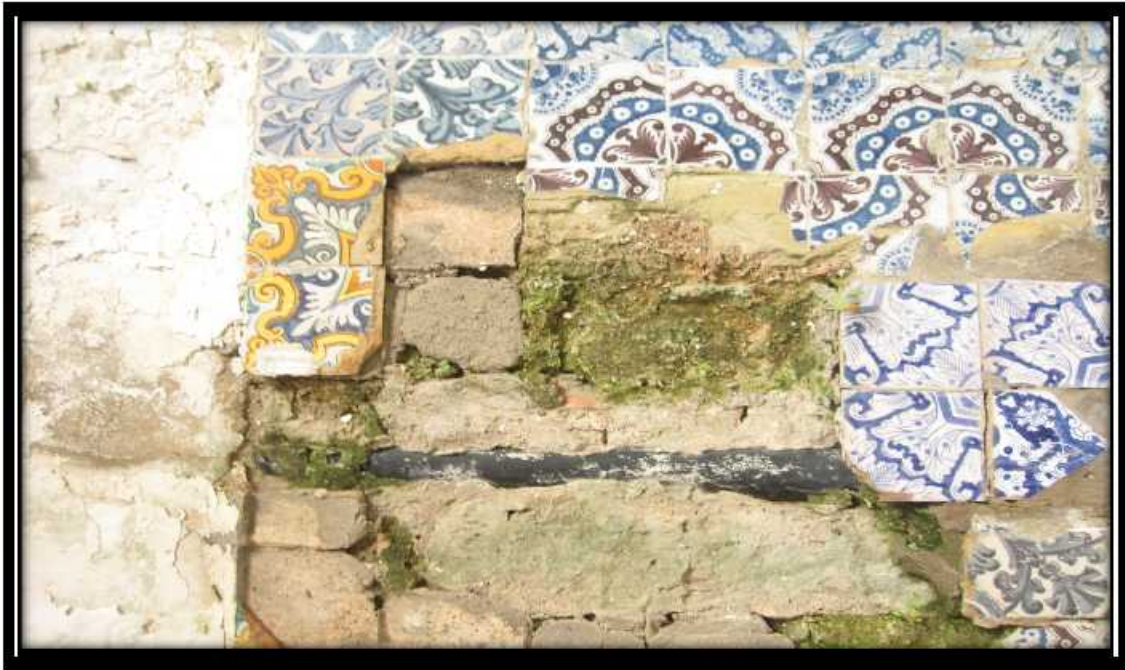
صورة (51) تظهر مرور قنوات الصرف الصحي التي تسبب في تكون الفطريات بالإضافة الى الرطوبة على سطح البلاطات.
