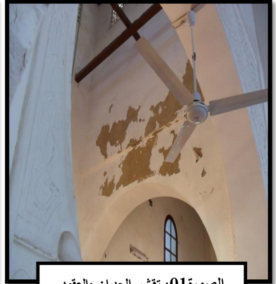
الصورة 01: تقشر الجدران والعقود بسبب الرطوبة
