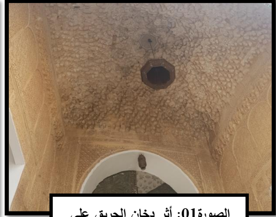
الصورة 01: أثر دخان الحريق على مقرنصات قبة مدخل الجامع
