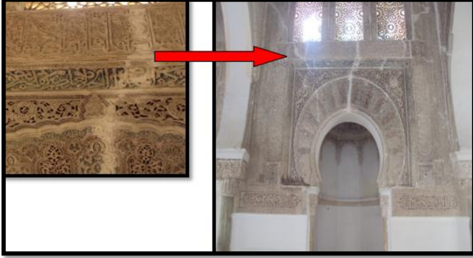
الصورة 31: تشققات عديدة بواجهة محراب مسجد أبي الحسن التنسي
