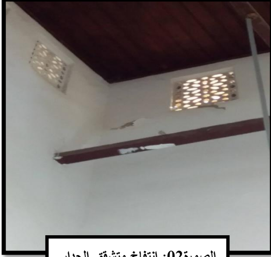
الصورة02: انتفاخ وتشقق الجدار بسبب الرطوبة
