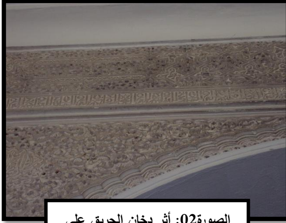
الصورة 02: أثر دخان الحريق على زخارف عقود بيت الصلاة
