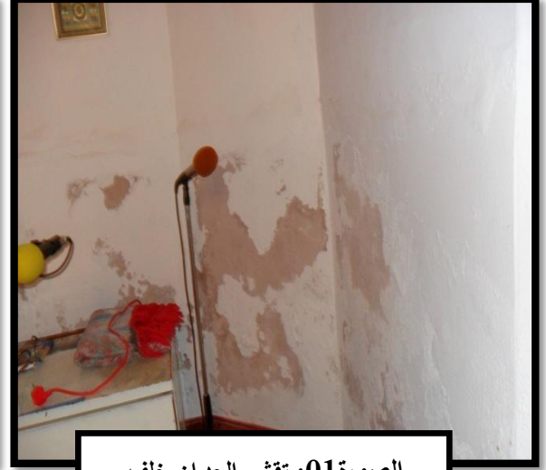
الصورة01: تقشر الجدران خلف المحراب وداخل المقصورة
