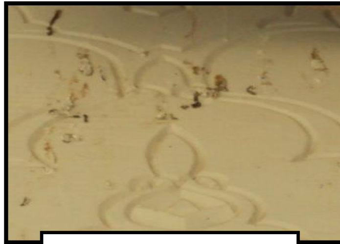
الصورة37: فضلات الطيور على واجهة جدران مسجد سيدي الحلوي.
