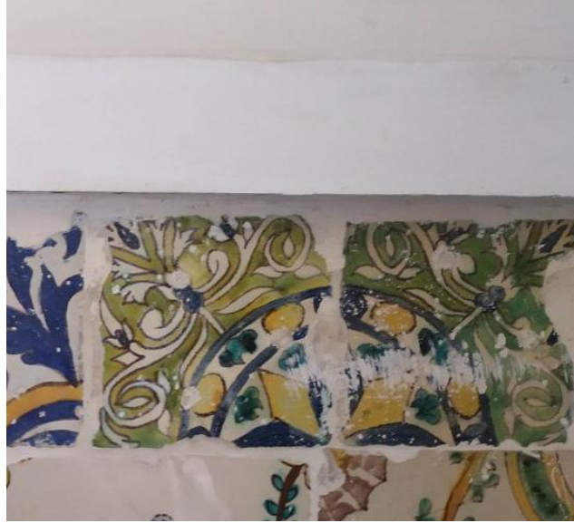
الصورة رقم 33: أخطاء الترميم (تلف بشري)
