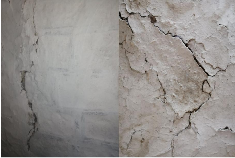
صورة 25: تشقق وتصدع جدران المبنى الريفي لبوزفن بمنطقة عزازفة (المصدر: عمل شخصي للطالبتين، 2022)
