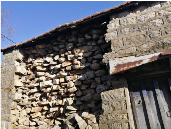
صورة 27: انهيار جزئي للمسكن (المصدر: عمل شخصي للطالبتين، 2022)
