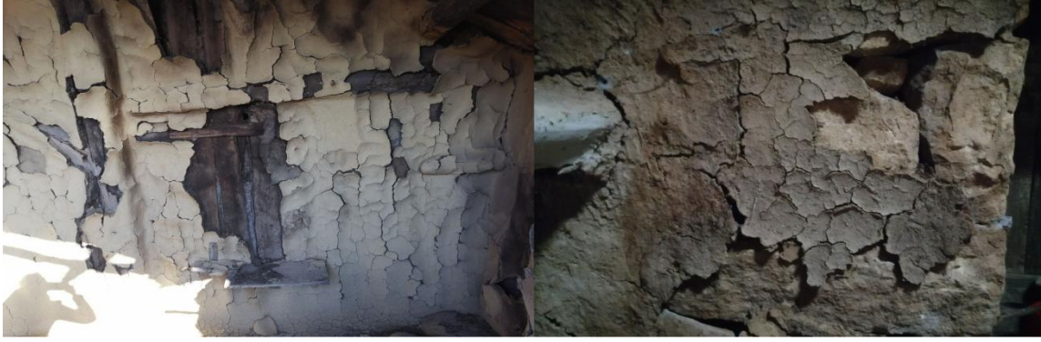
صورة 24: تقشر طلاء جدران المبنى الريفي بعزازفة بمنطقة تيزي وزو (المصدر: عمل شخصي للطالبتين، 2022)
