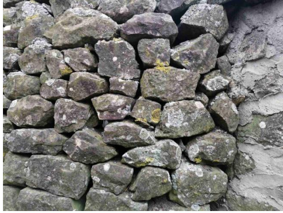
صورة 21: الترميم العشوائي للمبنى، باستعمال مولة الاسمنت بالمبنى الريفي ببوزقن بمنطقة تيزي وزو (المصدر: عمل شخصي للطالبتين، 2022)
