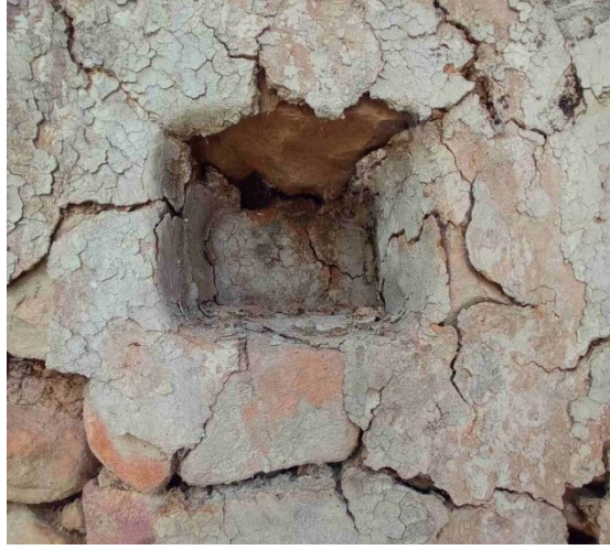
صورة 28: تشقق وتصدع المبنى (المصدر: عمل شخصي للطالبتين، 2022)
