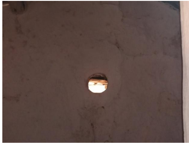
صورة 12: صورة توضح فتوحات التهوية داخل المنزل (المصدر: عمل شخصي للطالبتين، سنة 2022)
