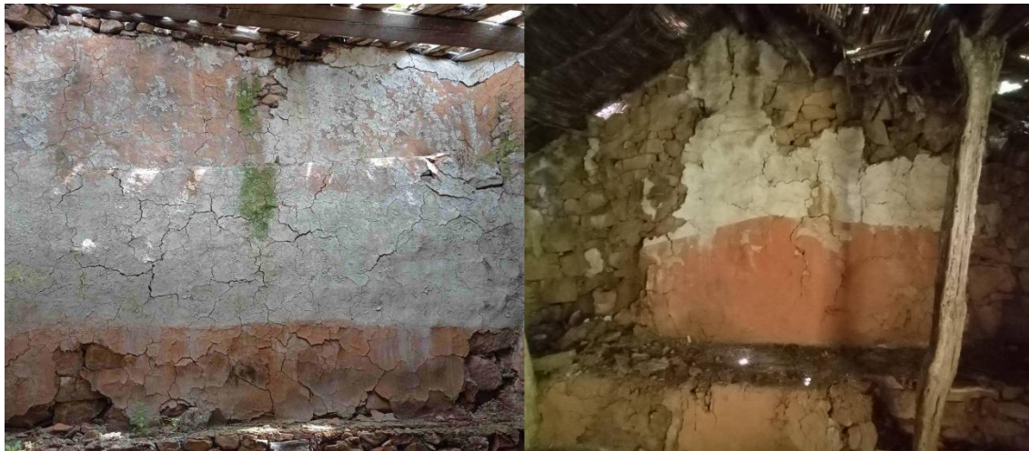
صورة 23: تقشر ملاط التكسية داخل جدران المبنى الريفي بعزازقة بمنطقة تيزي وزو (المصدر: عمل شخصي للطالبتين، 2022)
