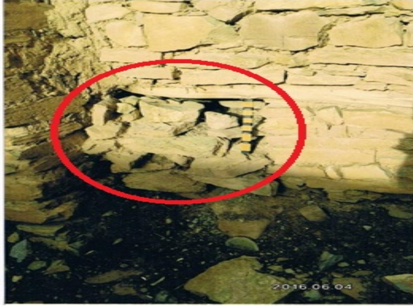
الصورة رقم (16): فتحة تفريغ الكنيف مسكن الأغواط
