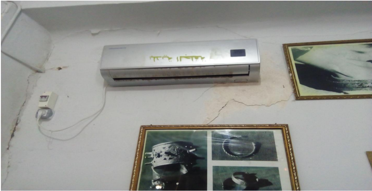
صورة رقم 63 تداعي مبنى العرض
