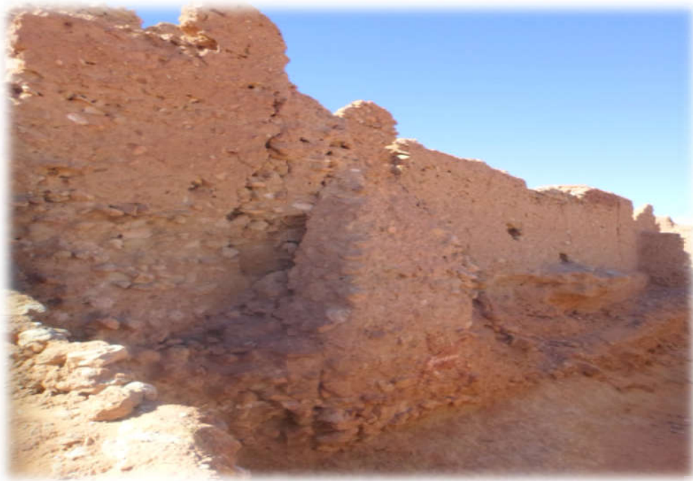
الصورة ب أحد أجزاء السور الخارجي - الجهة الشرقية - وقد تضرر بشدة
