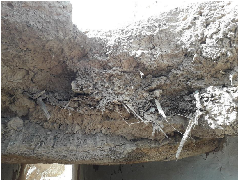
الصورة 29: انهيار أجزاء من السقف
