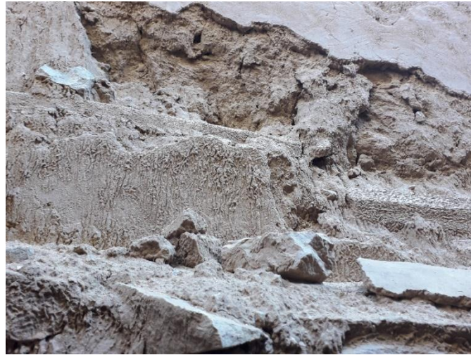
الصورة 28: تأثير المياه الجوفية على الجدران، من إعداد الطالبة
