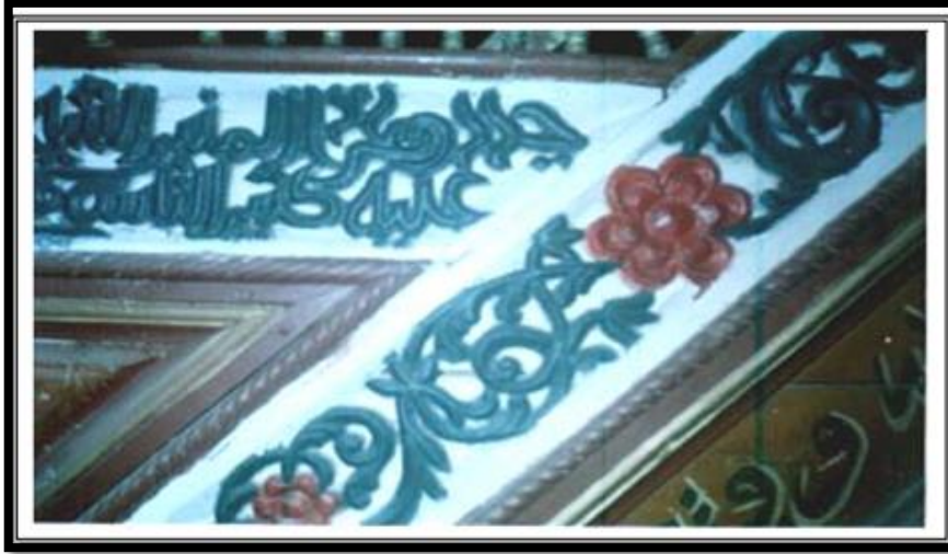
صورة رقم 01 الكتابة و الزخرفة النباتية بمسجد العتيق بمستاوة قبل الترميم
