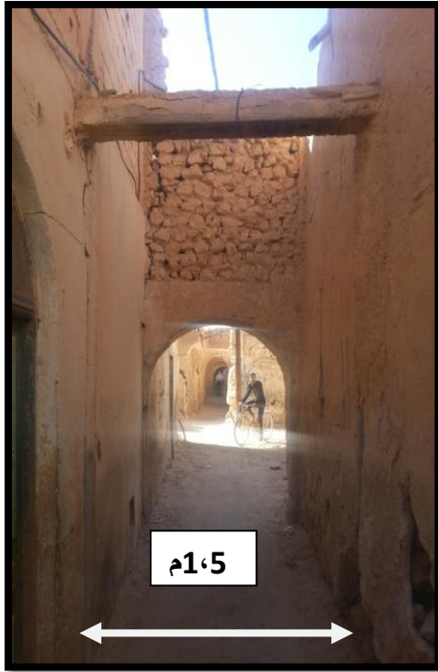
صورة رقم 02 ممرات مسدودة بقصر مستاوة 1,5م
