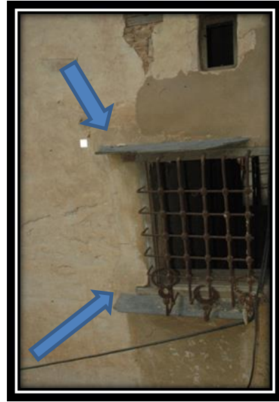
الصورة رقم 118: استعمالات صفائح من الأردواز
