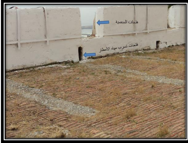
الصورة رقم 72: الطبانة الثانية فتحات المدفعية و فتحات تسرب مياه الأمطار
