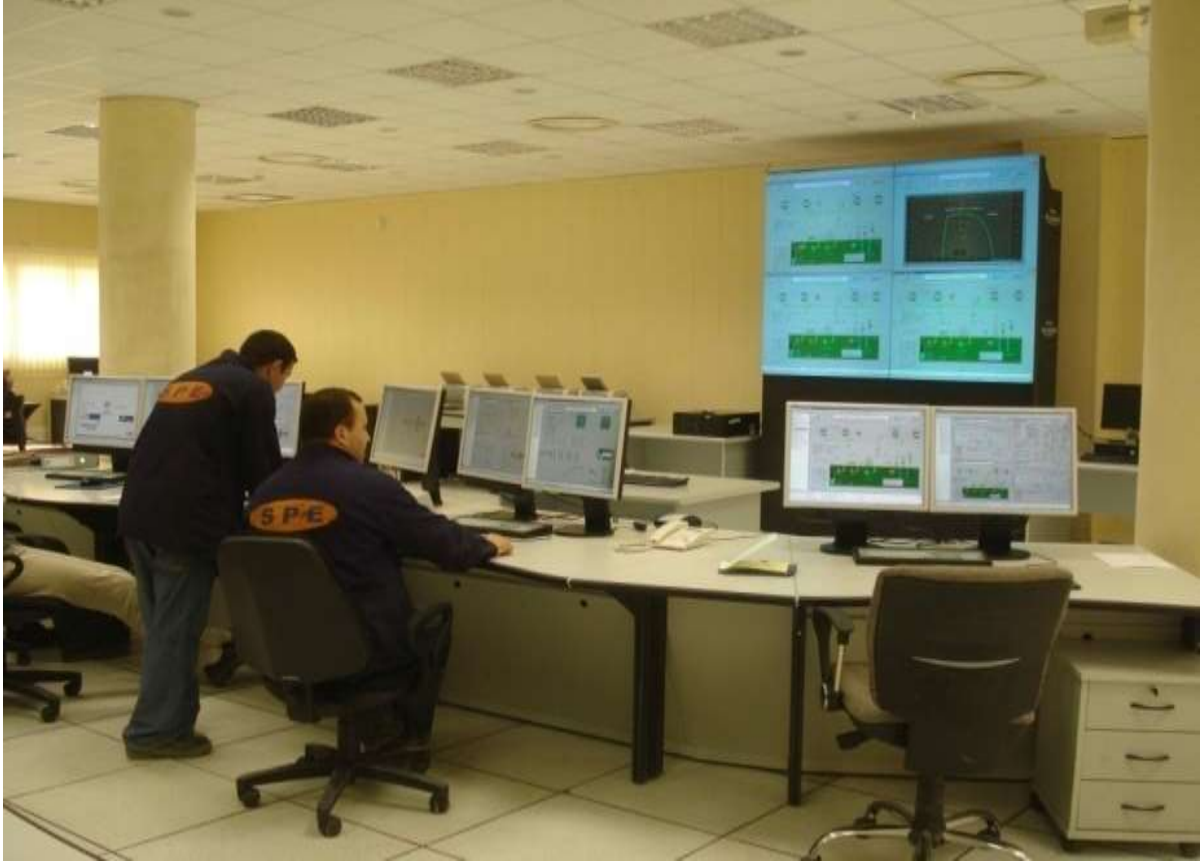
الشكل (14.5): صورة لغرفة المراقبة بمحطة الأربعا بالبيدة.
