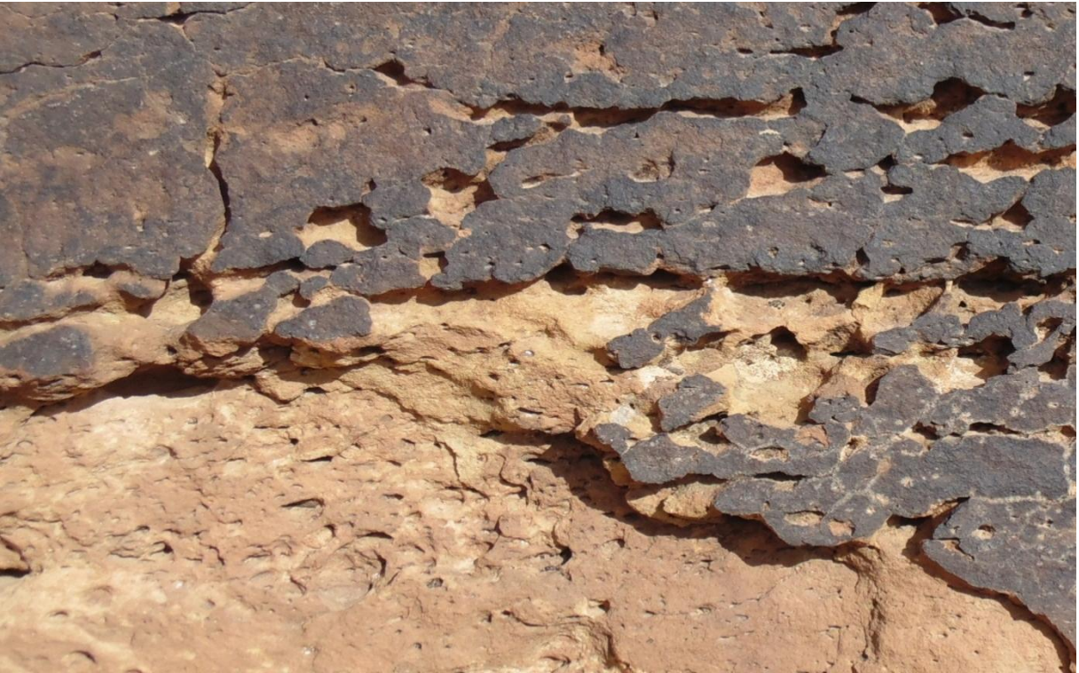
(الصورة رقم : 41 تمثل تآكل اسطح الواجهات )
