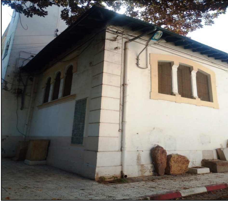
الصورة رقم 21: حالة حفظ بناية جناح الآثار القديمة بالمتحف المصدر: من تصوير الطالبة
