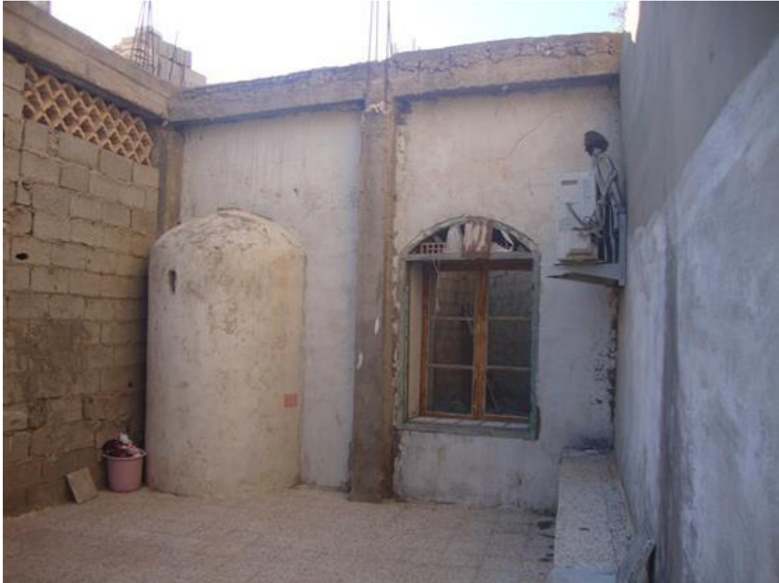
الصورة رقم(118): الترميم الخاطئ باستعمال مواد حديثة.
