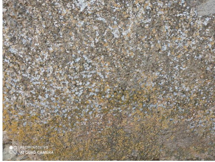
الصورة رقم(101): الأشنيات والطحالب على مستوى سطح الجدار الخارجي.
