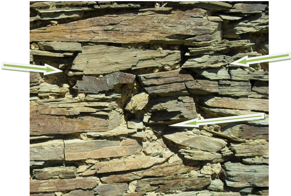
الصورة رقم(84): تآكل الحجارة والملاط بفعل الرياح.
