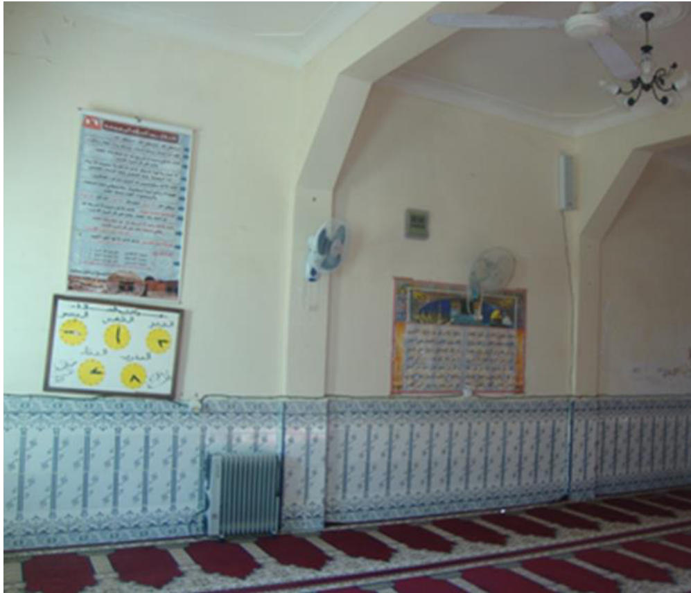
الصورة رقم(120): الترميمات الخاطئة.
