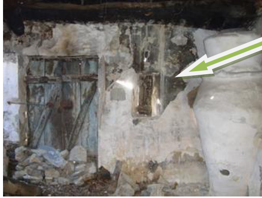
الصورة رقم (104): تآكل الجص بفعل السيول والأمطار.
