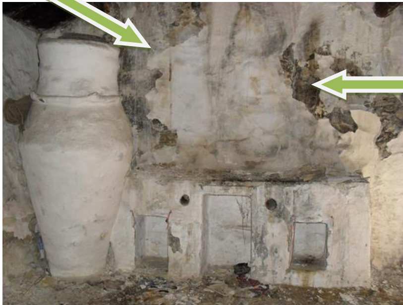
الصورة رقم (75): تفتت وتفتخ ملاط التكسية (الجبس) بسبب تشبعها بالرطوبة.
