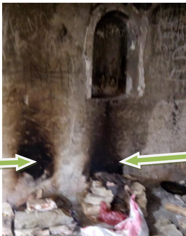
الصورة رقم(87): تشويه الجدار بفعل الحريق.
