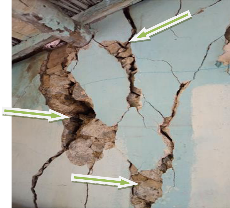
الصورة رقم (82): تشقق وتصدع في الجدار.
