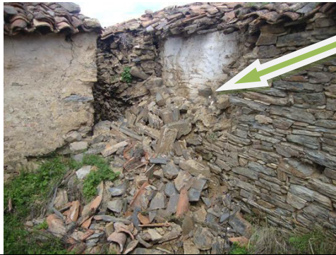
الصورة رقم (105): سقوط الجدار بفعل الزلازل.
