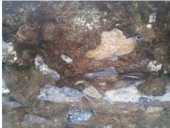
الصورة رقم(102): الطحالب في الجدران المباني التقليدية.
