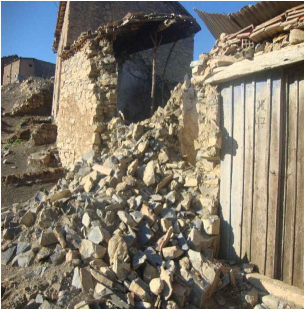
الصورة رقم(74): سقوط جدار بسبب الاهتزازات.
