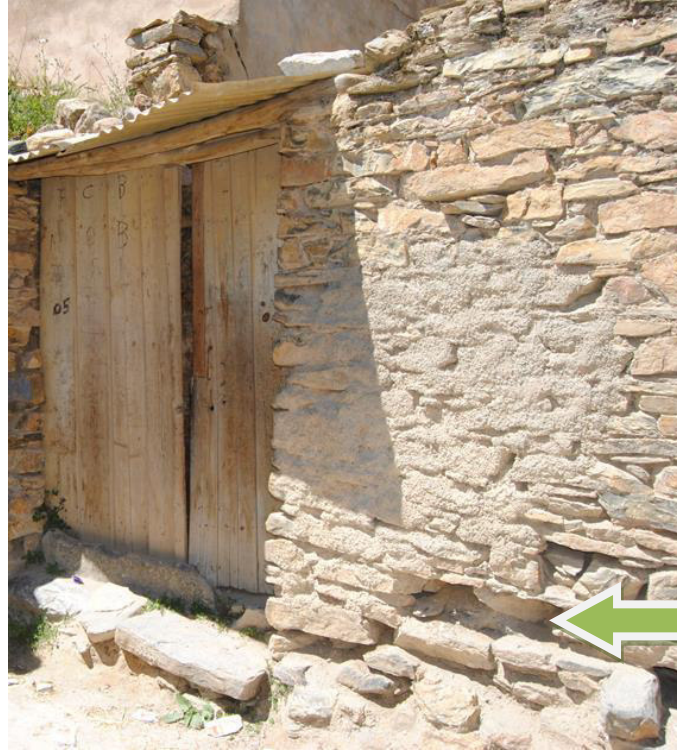
الصورة رقم(76): إحداه فجوات على مستوى الجدار.
