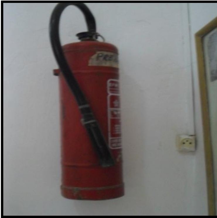
الصورة رقم 03 قارورات إطفاء الحريق
