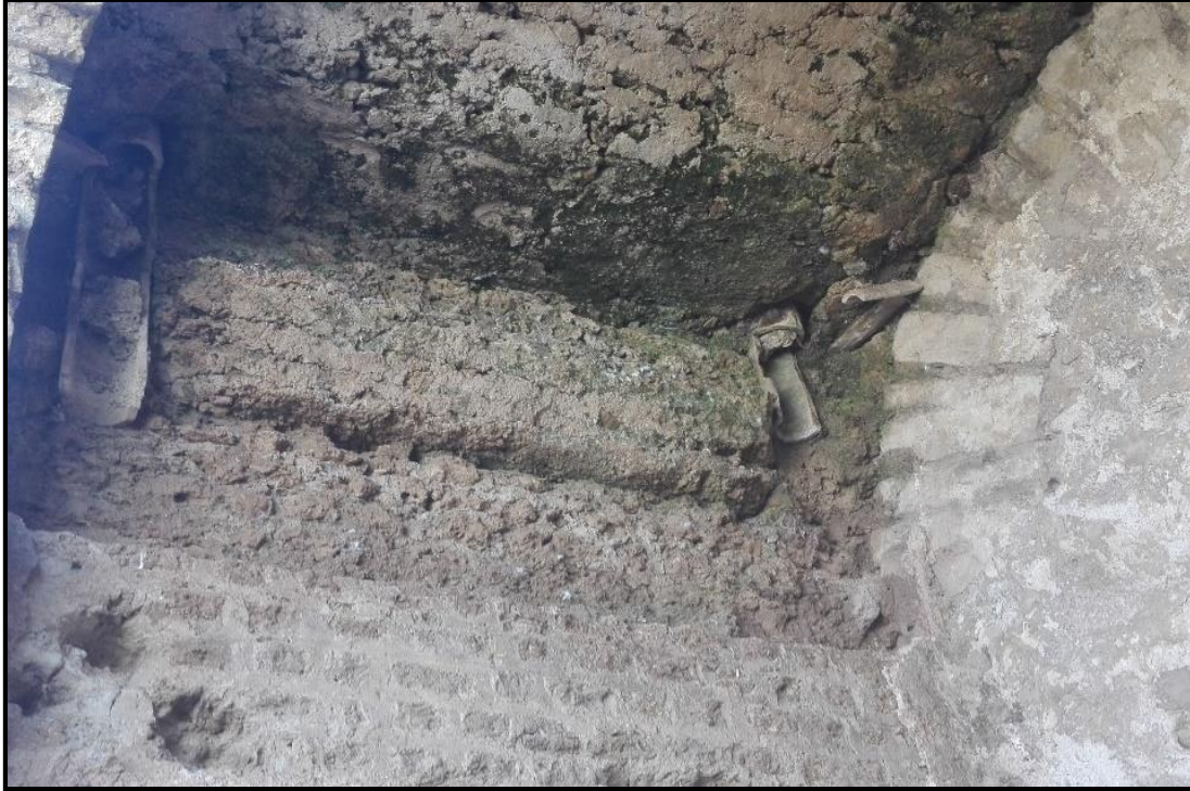
الصورة رقم 73: تلوث جدران وأسقف على مستوى الحمامات الكبرى باللون الأخضر نتيجة نمو الطحالب
