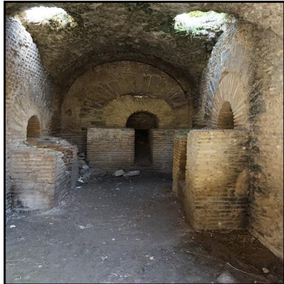
الصورة رقم 42: تبين مظهر الحرق في الطابق تحت الأرضي للحمامات الكبرى
