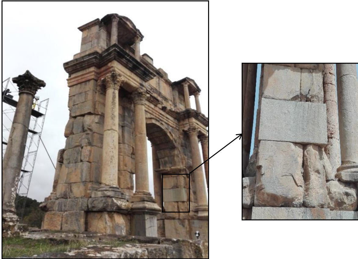
الصورة رقم 23: توضح تشقق الحجارة تحت تأثير الأحمال
