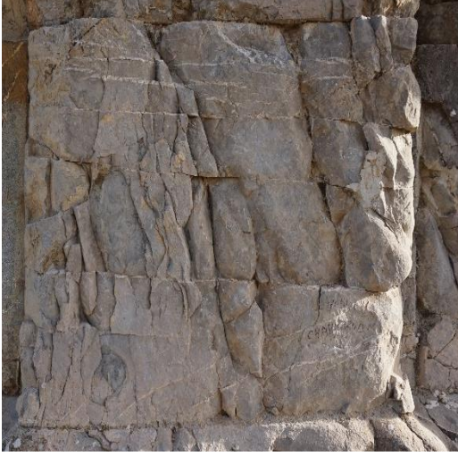
الصورة رقم 80: تبيين تشقق وانفصال بفعل الجليد بقاعدة قوس كركلا
