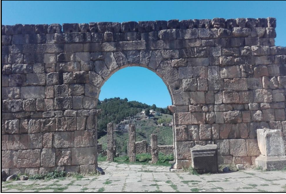
الصورة رقم 49: تبين تركيب الكتل الحجرية بطريقة عشوائية في الجدار الشرقي على مستوى بازيليك جوليا
