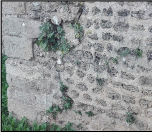
الصورة رقم 33: توضح نمو الشجيرات وإحداث شروخ وتصدعات في إحدى جدران الحمامات الكبرى
