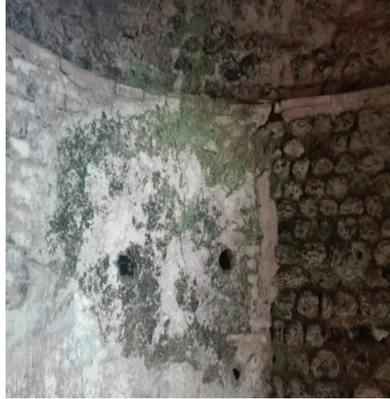
الصورة رقم 40: تبين نمو الطحالب الخضراء على جدران وأسقف إحدى قاعات الحمامات الكبرى
