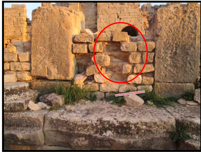
الصورة رقم 21: سقوط الحجارة
