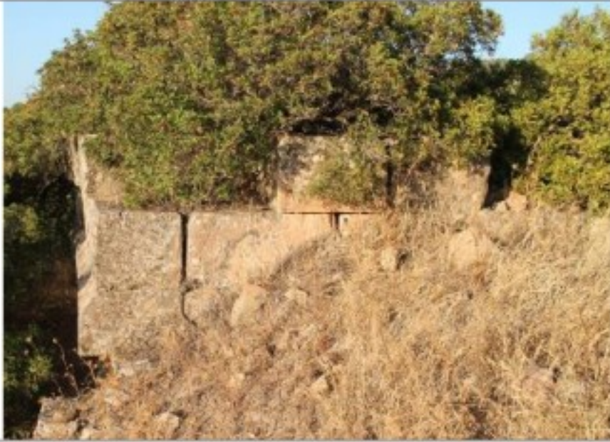
صورة رقم 6: جانب من قاعدة البناية الموجودة في الجهة الشمالية الشرقية للقصر.
