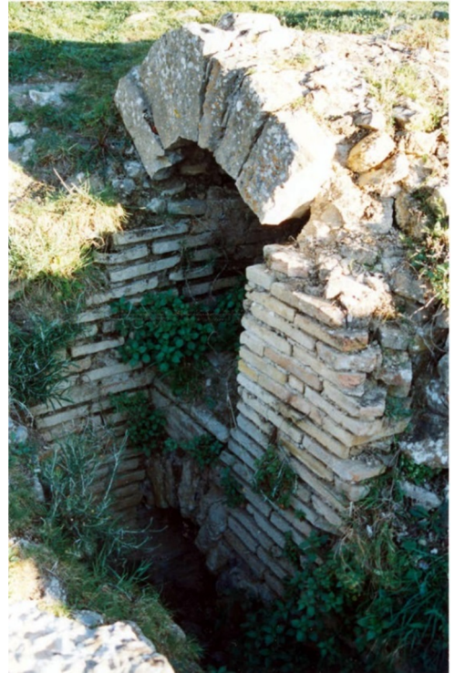
صورة (6): قناتين آتيتين من الحمامات الخاصة الشكل (2): قنوات صرف المياه الواحدة فوق الأخرى بمنزل كاستوريوس
