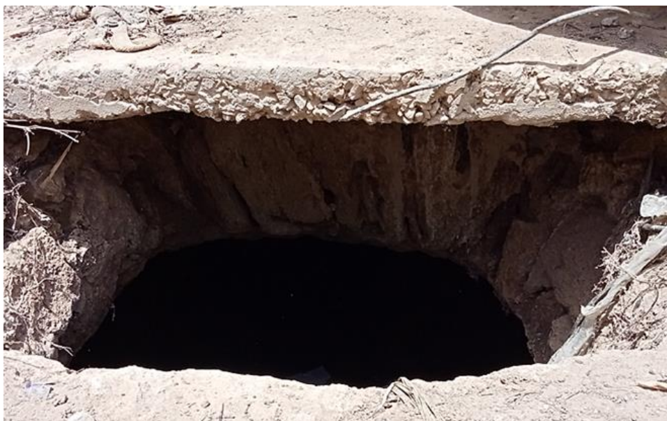
صورة 143: خزان مياه ورشة قلتة
