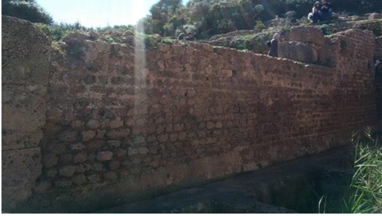
صورة 104: الجدار الجنوبي للورشة يُظهر آثارا للملاط في جزئه السفلي.
