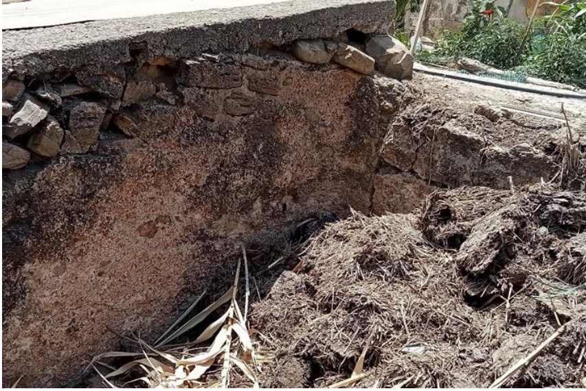
صورة 77: تفاصيل حوض من مصنع قلته يوضح الملاط المائي المحفوظ في الحوض وتقنية البناء بالحجارة الصغيرة الغير منتظمة.
