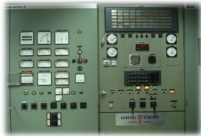
salle de commande
