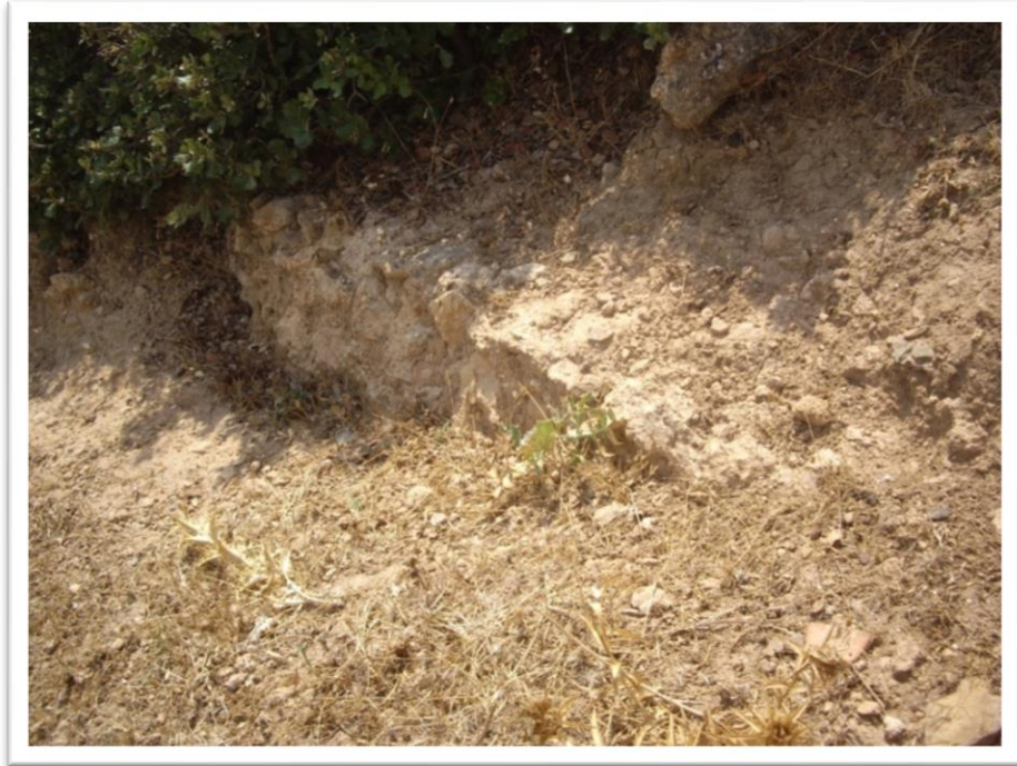
الصورة 125 القناة الناقلة. عن الطالبة
