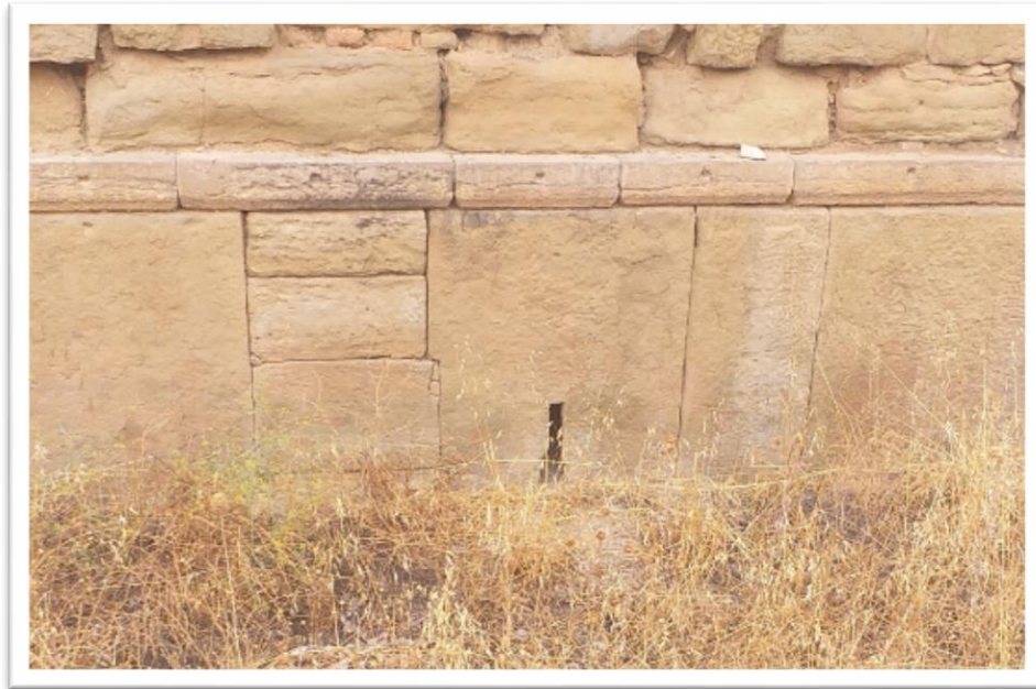
الصورة 208 فتحة تدفق المياه من جدار الغربي الداخلي للحوض. عن الطالبة
