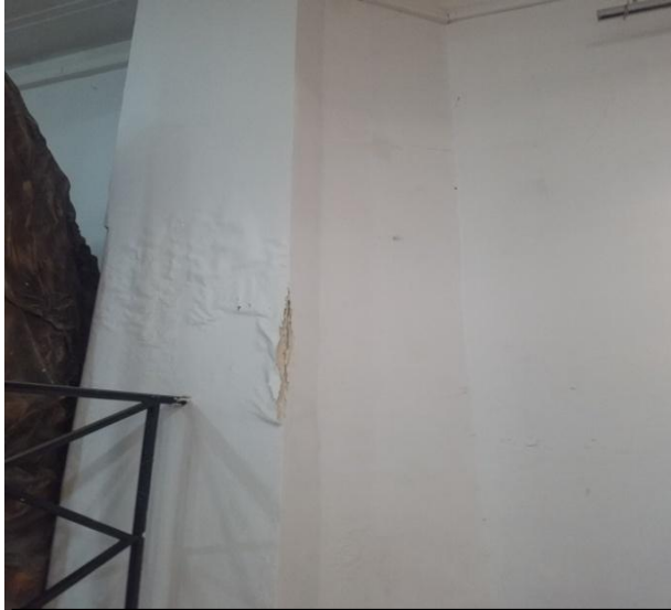
الصورة رقم (02): تقشرات في الجدران بفعل الرطوبة - الصورة من متحف زبانة
