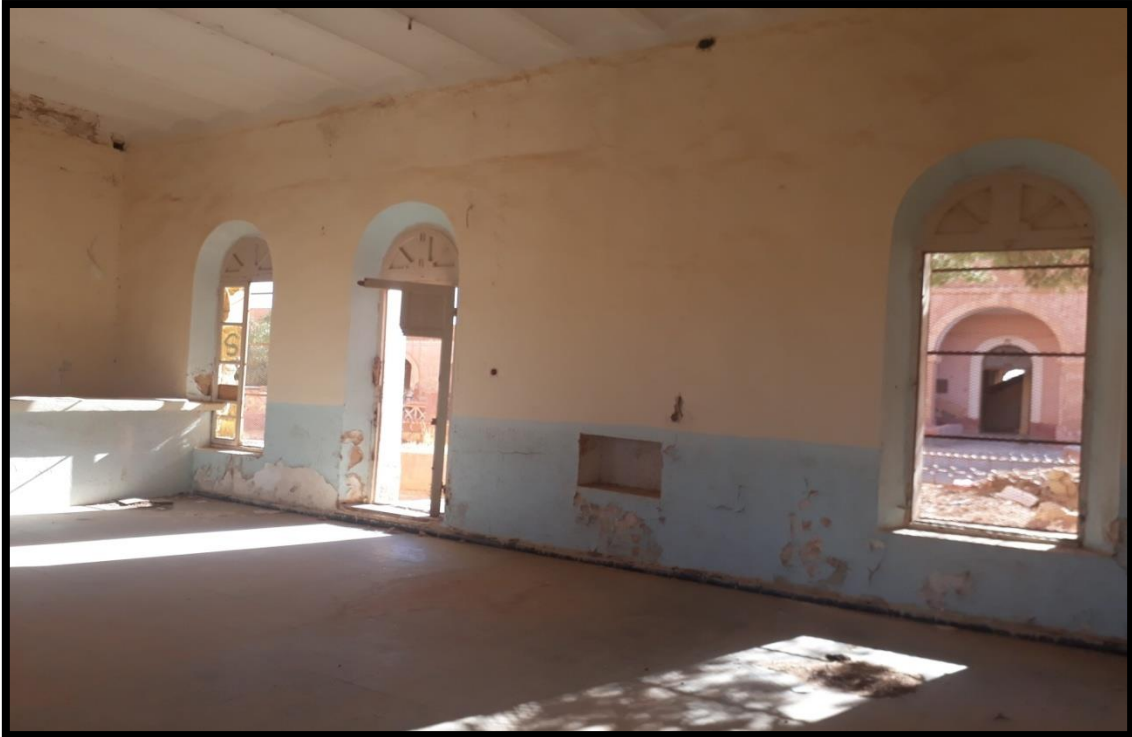
الصورة(24): إحدى غرف الملحقة الشمالية في حالة تدهور
