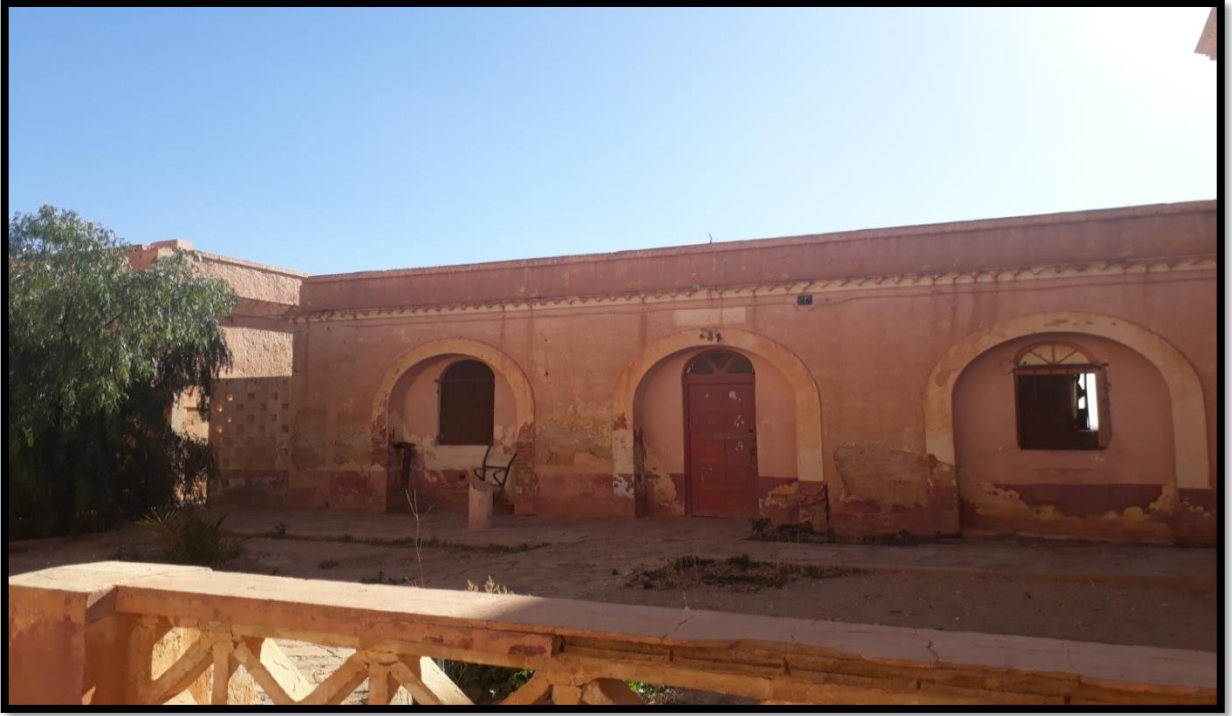
الصورة(25): تصاعد المياه الجوفية في جدار الملحقة الشمالية للحصن وتسبب في انتزاع طبقة التلييس
