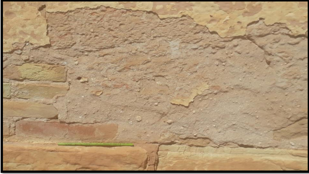
الصورة(11): انتزاع طبقة التلييس نتيجة الفعل الميكانيكي للجليد (برج بوسكارين)
