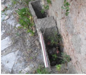
صورة رقم 021: فراغات لنقل الهواء الساخن
