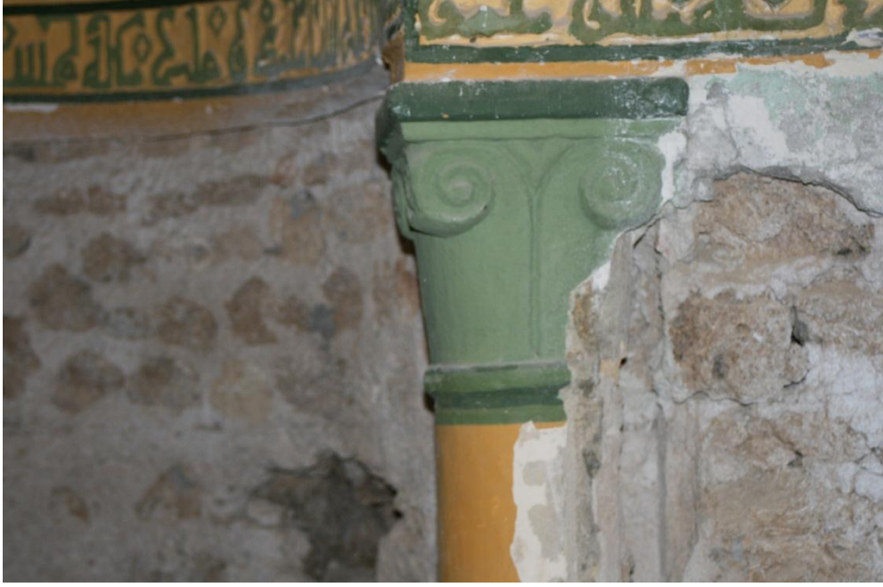
صورة رقم 12- أحد الأعمدة التي يرتكز عليها عقد المحراب - الجامع الكبير بقسنطينة أثناء عملية الترميم ( 2014 ) (من عمل الطالبة)
